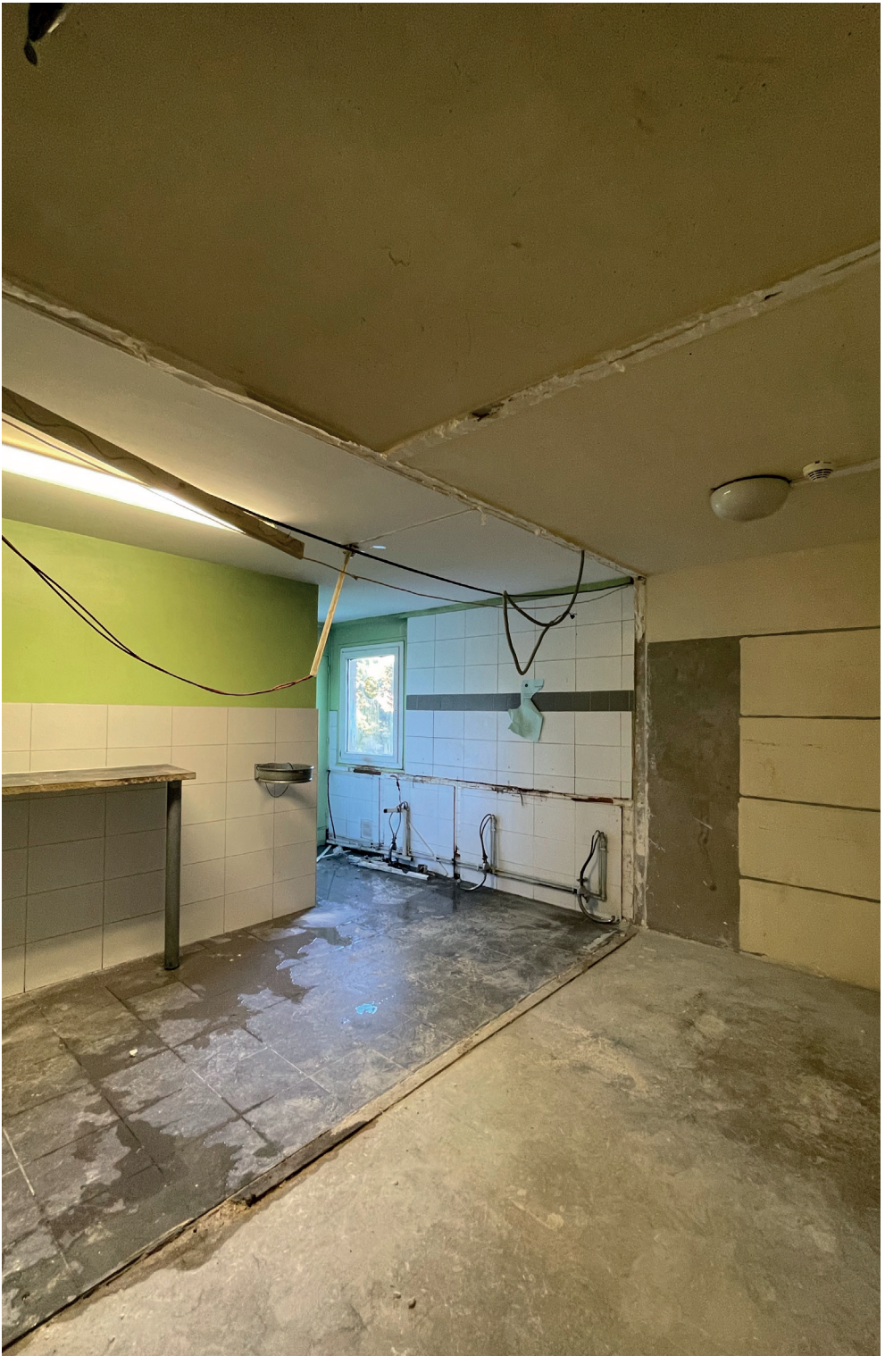
Cuisine du bâtiment M en cours de rénovation avec doublement de la surface - 2021
