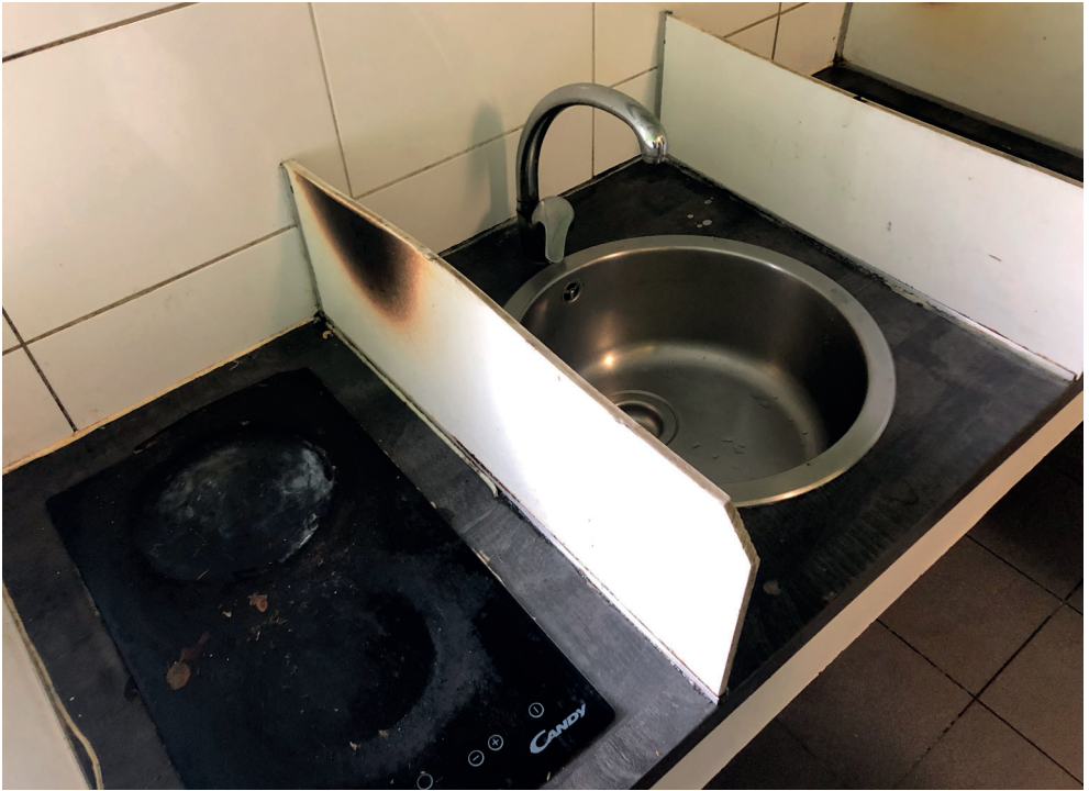
Cuisine d'origine du batiment M - 2021
